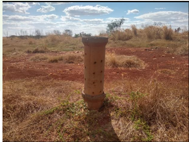
Dreno de gases existente no Aterro
